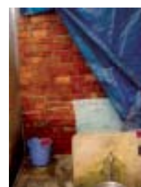
Toilettes sans mur ni porte foyer B
